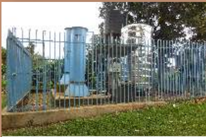
...Wasseraufbereitungsanlage in Mbirizi
